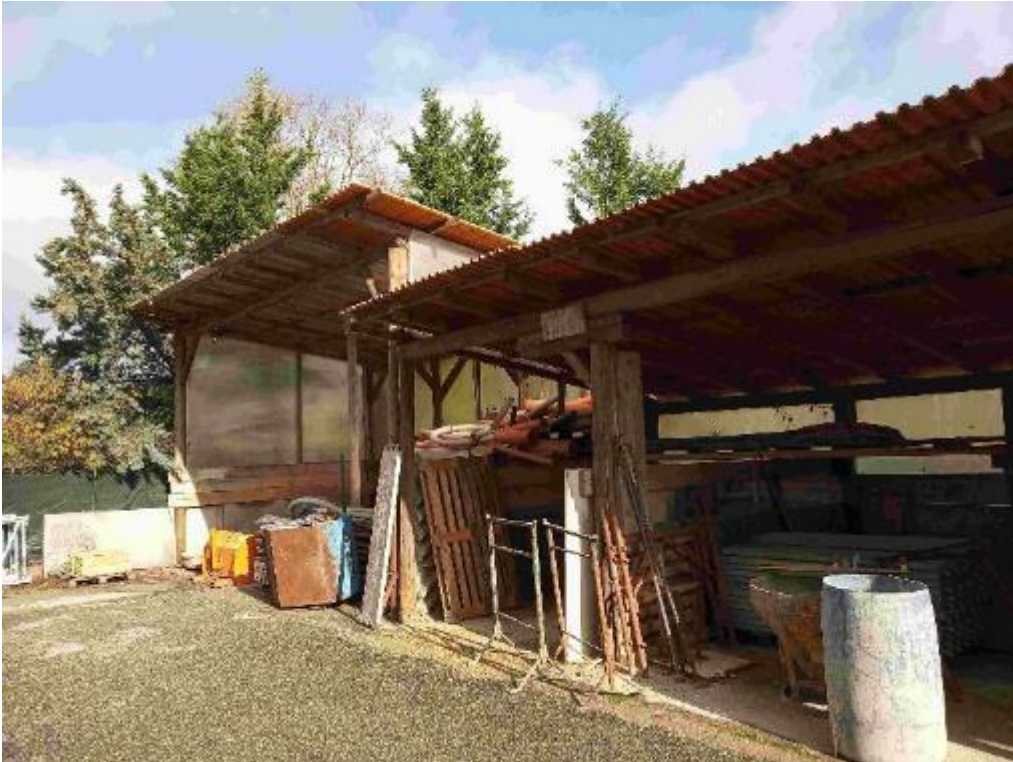
Foto 13 tettoie precarie lato est
