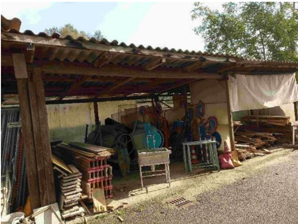
Foto 12 tettoie precarie lato est
